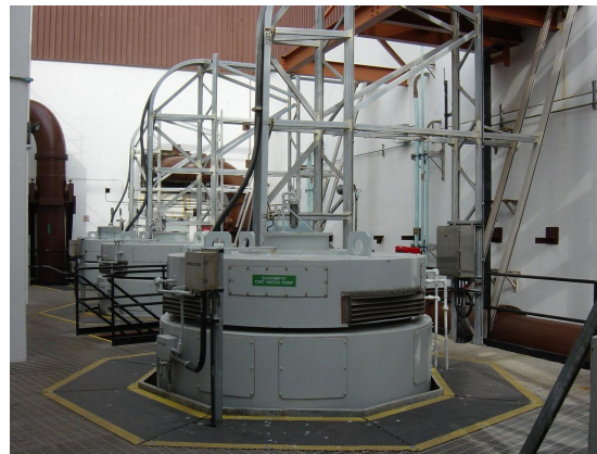
Pompe per la circolazione dell'acqua da 2500CV
