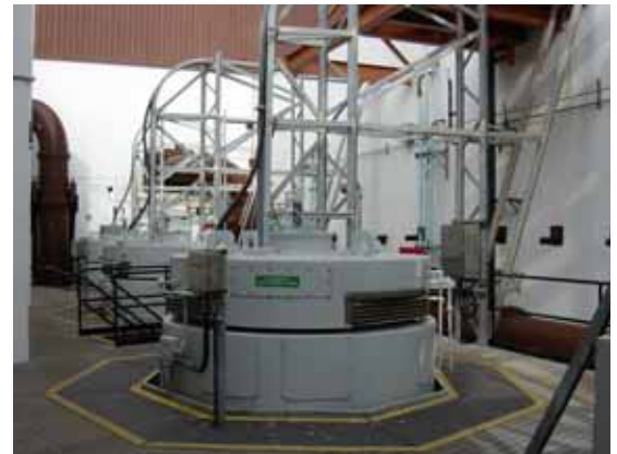
Pompe per la circolazione dell'acqua da 2500CV
